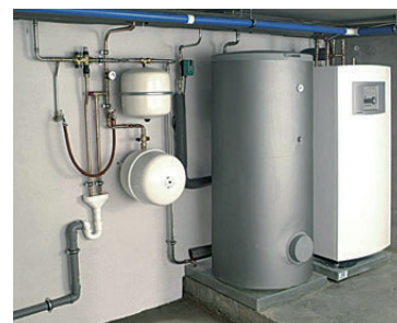
Wärmepumpe im Keller
