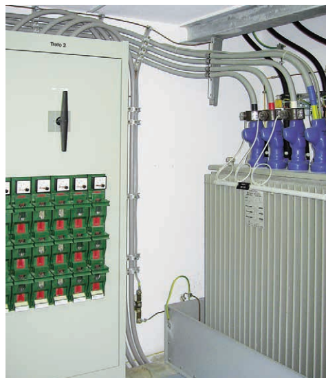
Rechts: Niederspannungs- verteilung und berührungs- sicherer Transformator mit einer Leistung von 630kVA
