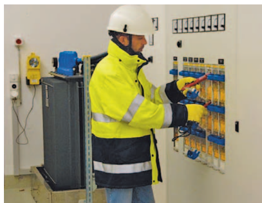
Christoph Hardmeier prüft in der Transformierstation Froschgülen die Sekundärspannung
