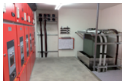
Neue Transformierstation Post: Schalter und Transformer
