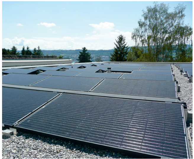
Photovoltaikanlage Kinderbetreuungshaus (Schulhausstrasse 41)
